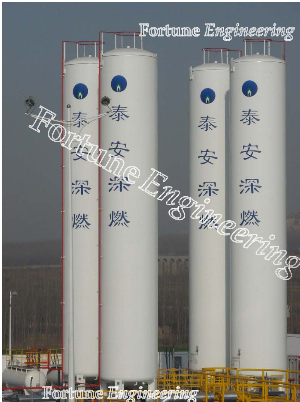
LNG Storage tanks
